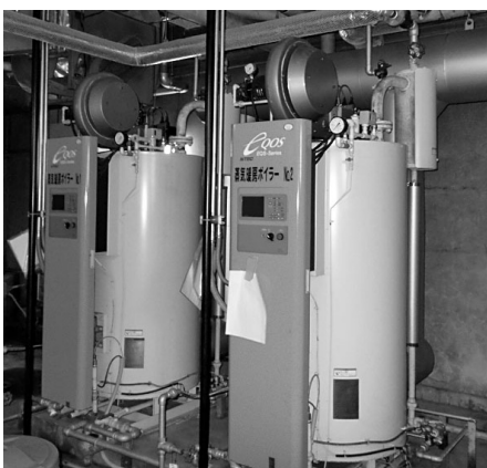
▲地下蒸気暖房ボイラー
