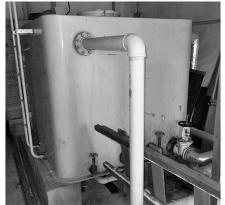
▲屋上搭屋貯水タンク
