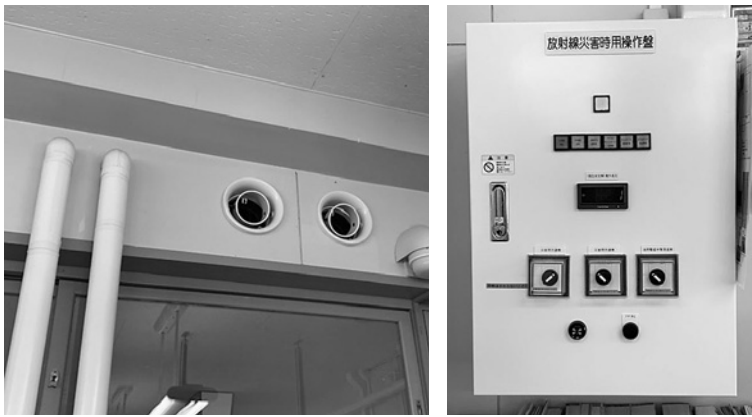
▲放射線防護施設校内空調システム（美国小学校）
