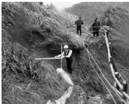
▲崩落した神威岬遊歩道の現地調査
