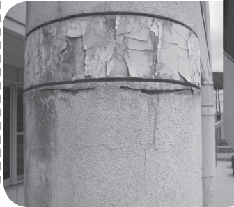
破片が崩落している ▼正面玄関前の柱
