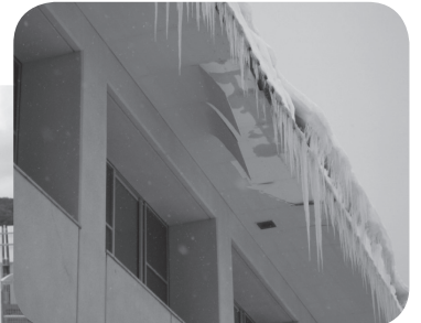
▲大雪の影響などで落下している軒天ボード
